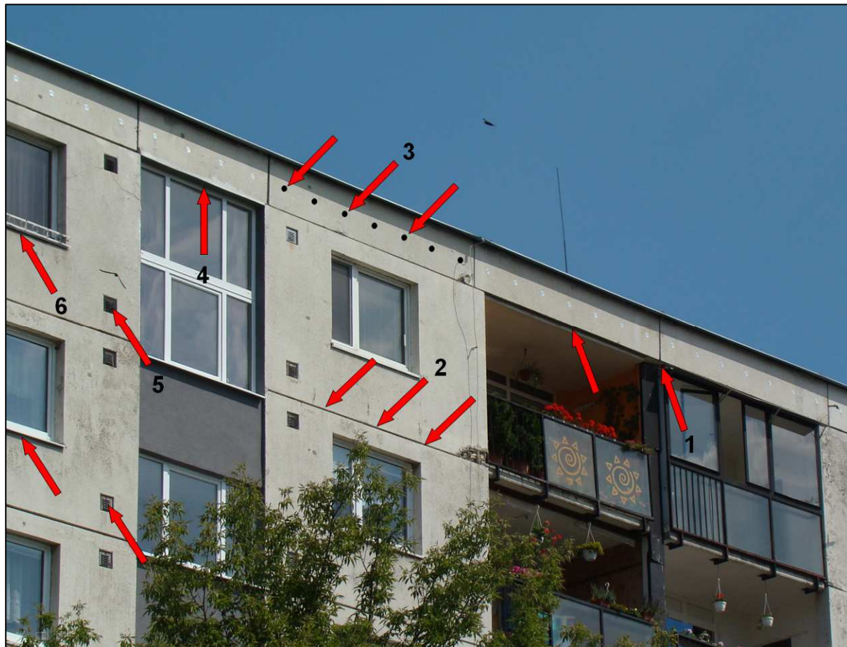
Obr. 5 Najčastejšie miesta kde netopiere nachádzajú vhodné štrbiny a dutiny: 1 – pod plechom nad balkónom, vliezajú tu do vnútra panelov, 2 – štrbiny medzi panelmi, 3 – vetracie otvory v atike, 4 – štrbina nad schodiskom, 5 – vetračky do kuchyne, 6 – pod parapetnými doskami.
